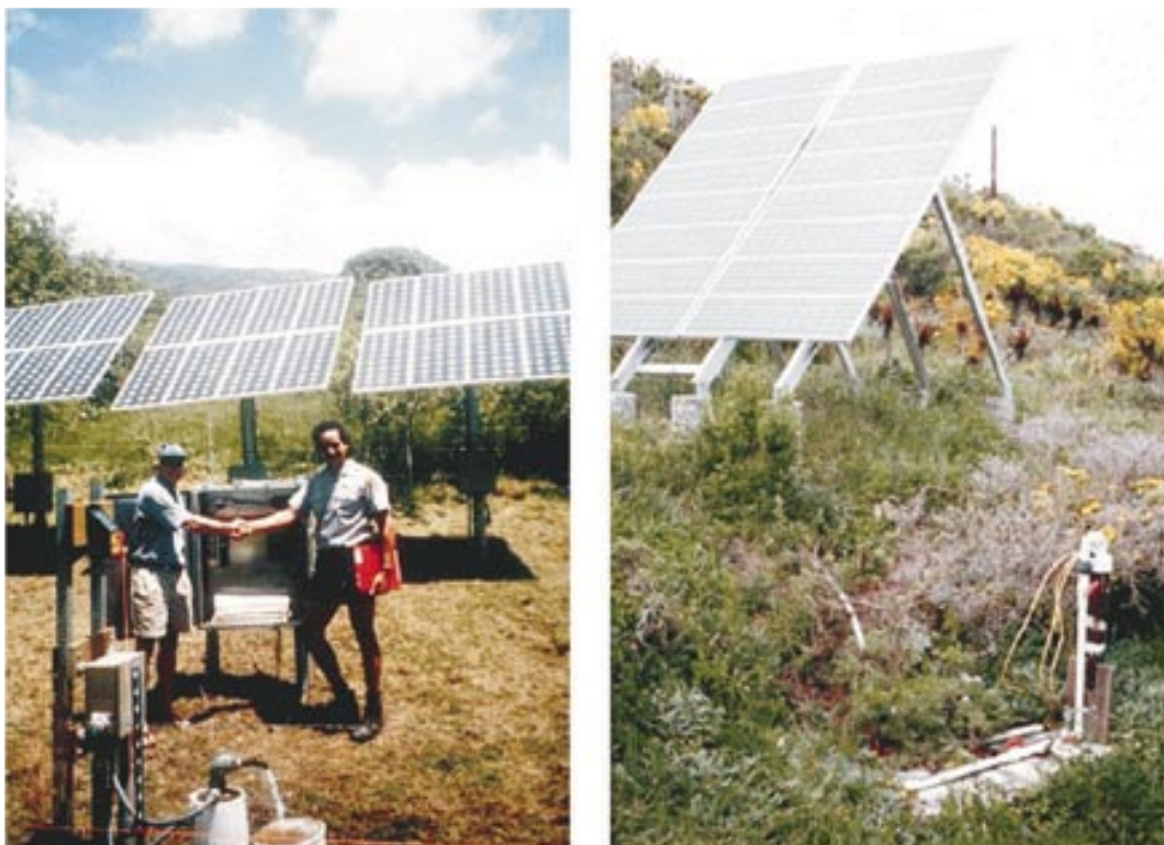
Figura 30. Dos ejemplos más de bombeo de agua en lugares aislados.
