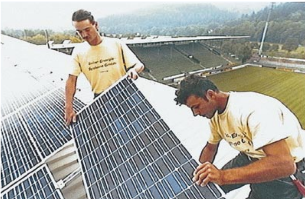
Figura 42. Montaje del campo solar en la cubierta de un estadio.
