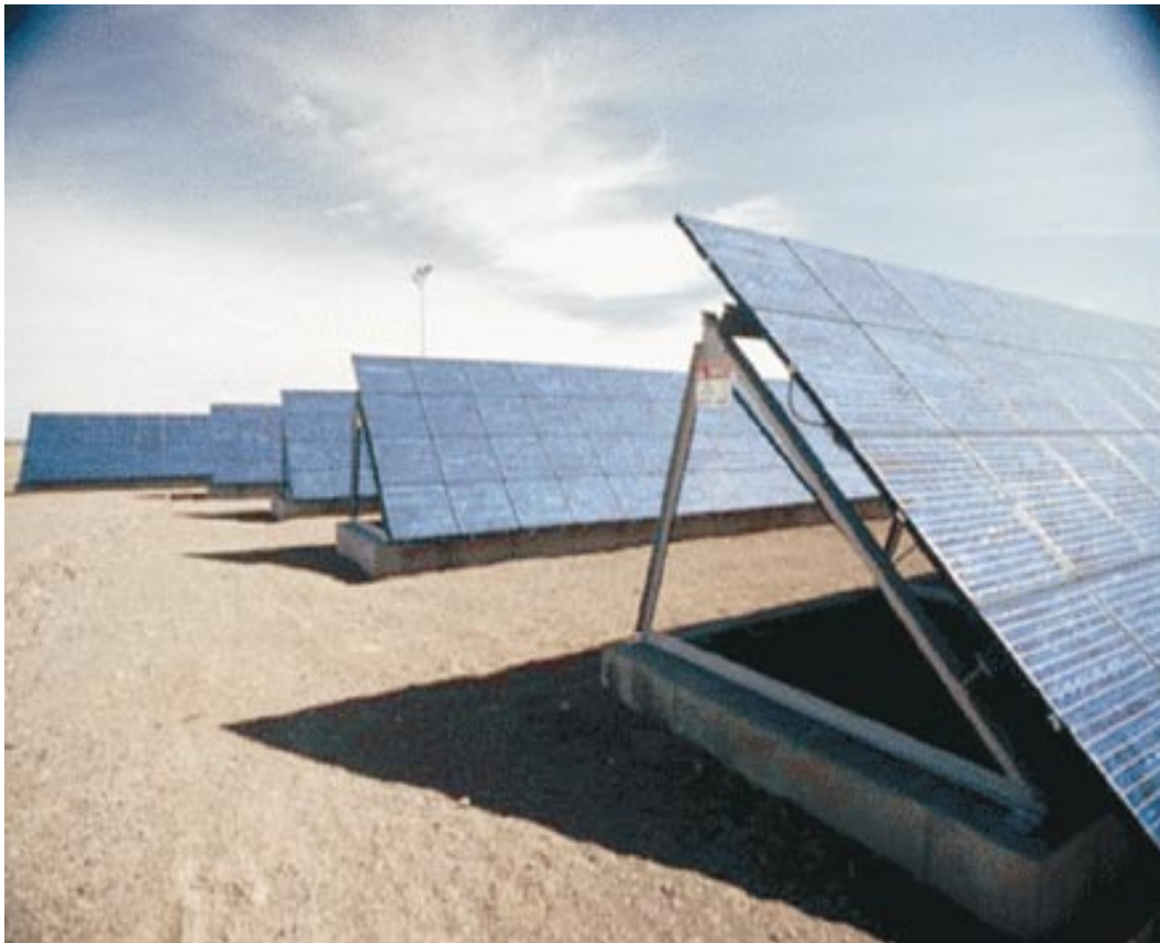
Figura 21. Campo de colectores en una instalación de conexión a red no doméstica
