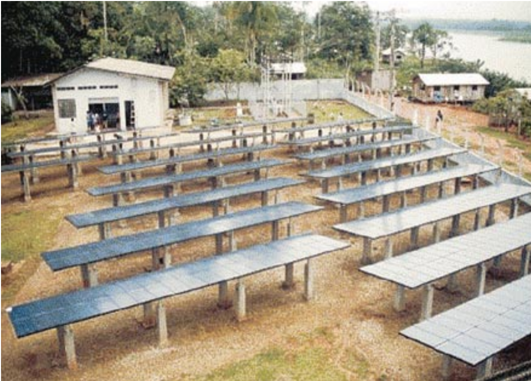
Figura 24. Ejemplo de electrificación de un núcleo rural.
