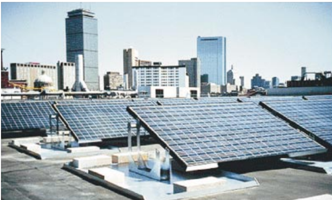
Figura 35. Instalación fotovoltaica de conexión a red colocada en la azotea de un edificio
