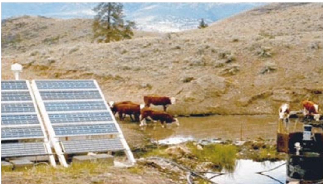
Figura 29. Bombeo fotovoltaico para abastecimiento de agua de ganado.
