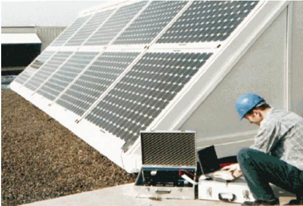
Figura 11. Ejemplo de instalación fotovoltaica constituida por varios paneles.
