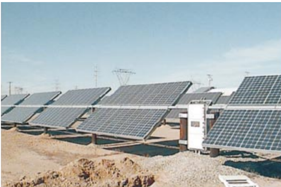
Figura 44. En grandes instalaciones conectadas a red es usual ver seguidores solares de un único eje.
