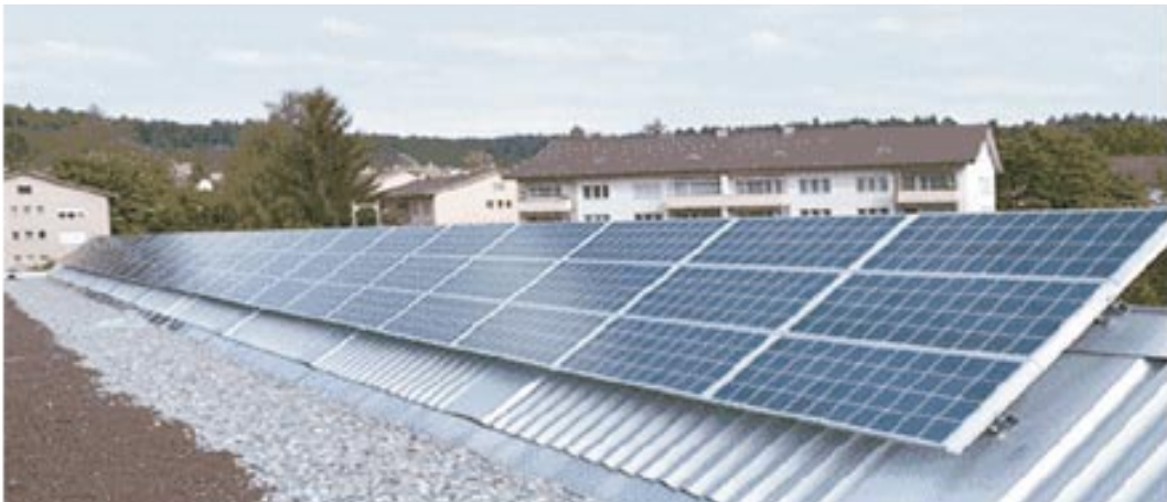
Figura 49. La accesibilidad al campo solar es importante en ambientes polvorientos para su limpieza.
