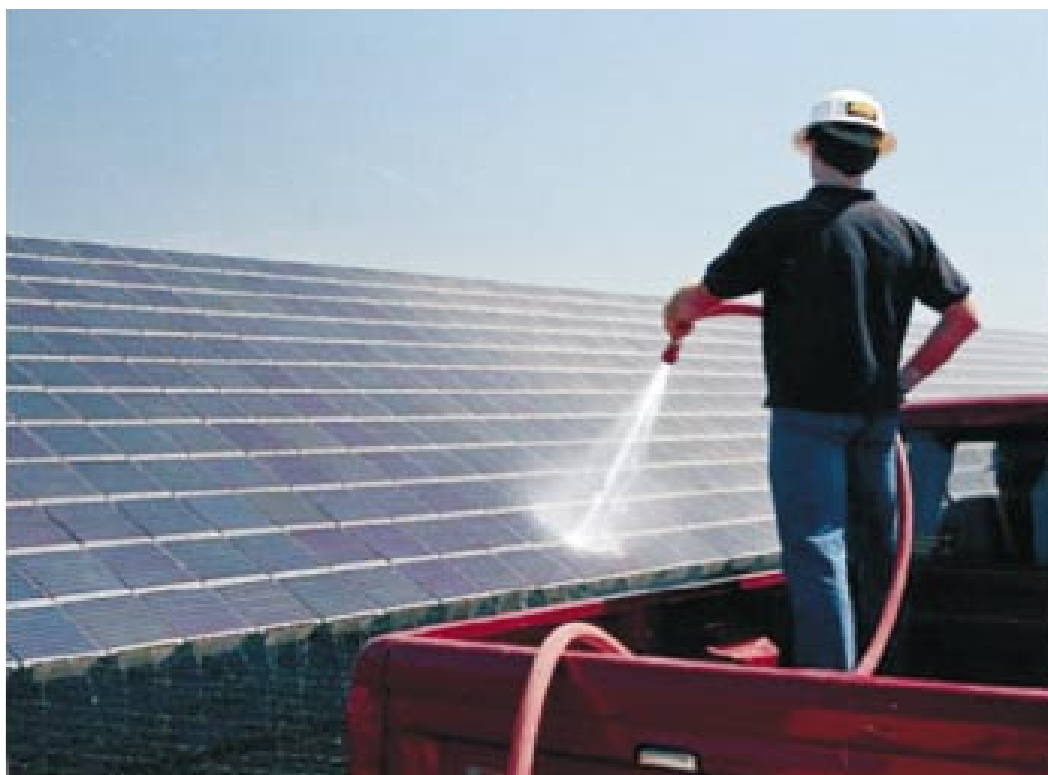
Figura 48. Operación de limpieza del campo solar en una instalación fotovoltaica.
